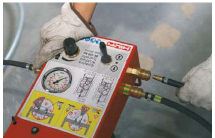
Pripojenie prívodu stlačeného vzduchu k ovládacímu panelu.
